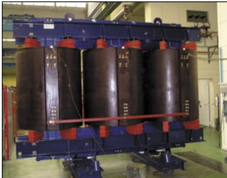
SGB-Regensburg-transformátory, DTTHL 1600/20, 16 MVA, 22/6,3kV -Dalkia a.s.
