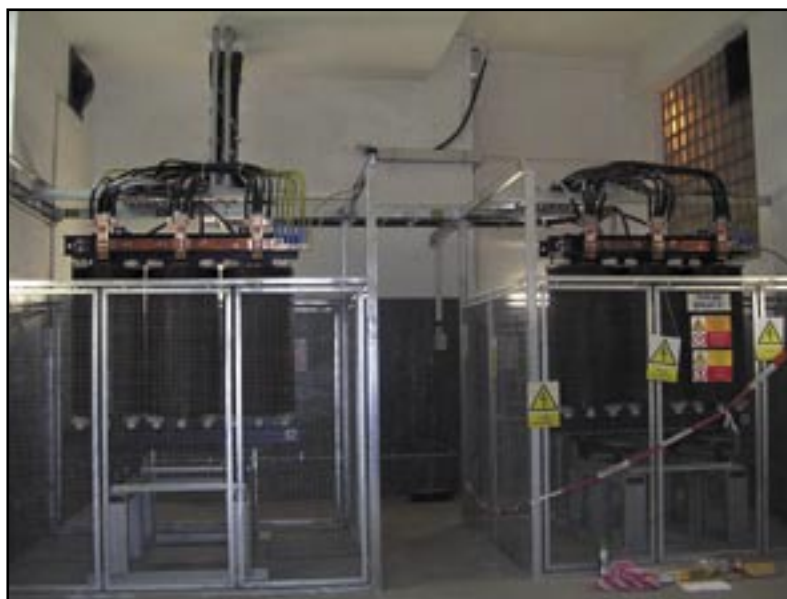
SGB-Regensburg-transformátory, DTTHL 1600/6, 1600 kVA, 6/0,42 kV -Dalkia a.s.
